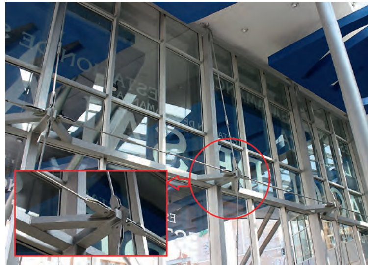
Figura 12: fachada con vidrios insertos entre montantes y travesaños de aleación ligera, que dispone de una estructura soporte de refuerzo posterior con perfiles metálicos unidos por medio de tensores de acero.
