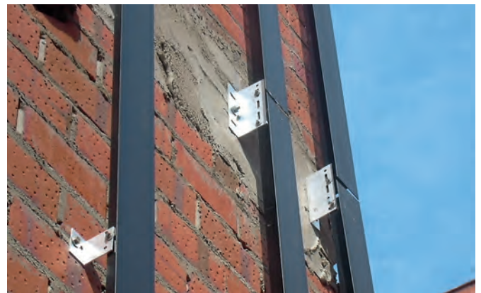
Fig. 5: colocación de los montantes y las escuadras de sustentación sobre la hoja principal de una fachada ventilada.
