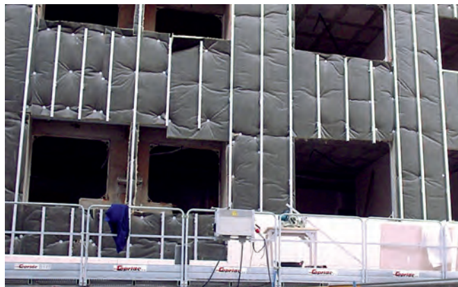
Fig. 6: fase de colocación de la subestructura de aluminio y del aislamiento en una fachada ventilada.
