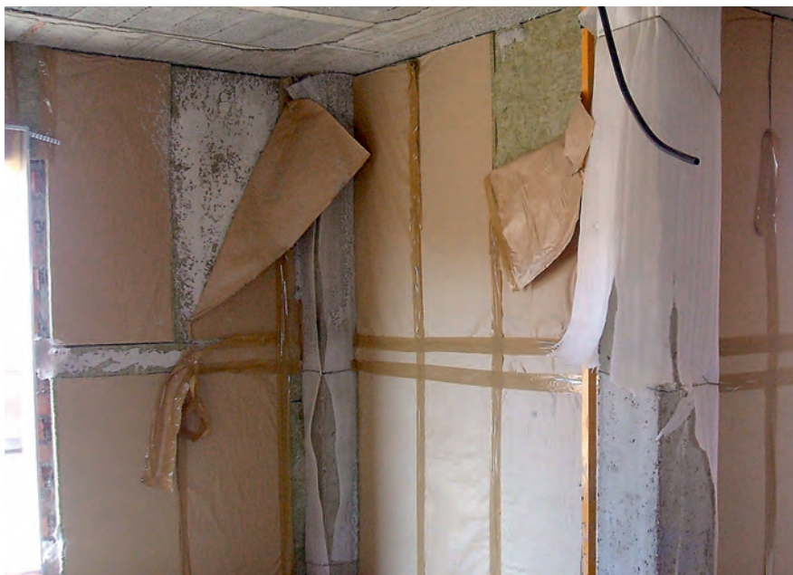
Fig. 5: proceso de colocación (con deficiencias) de un aislamiento de lana mineral en la cámara de aire de una fachada convencional.
