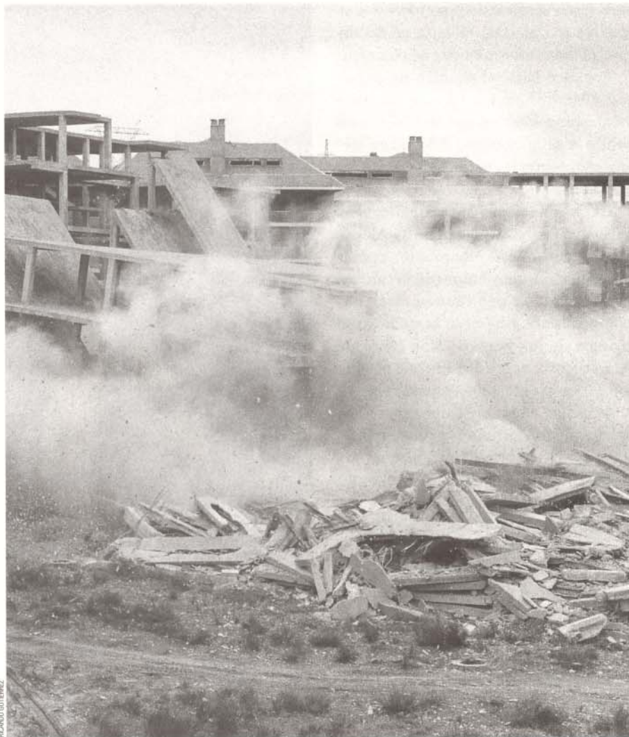
Musaat ha investigado los defectos en la construcción.
