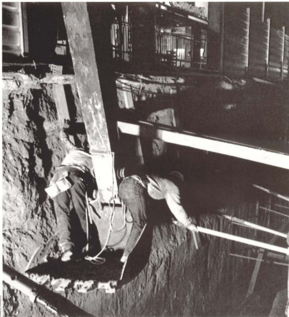
Desprendimiento de tierra en la construcción de un aparcamiento municipal en Alicante.
