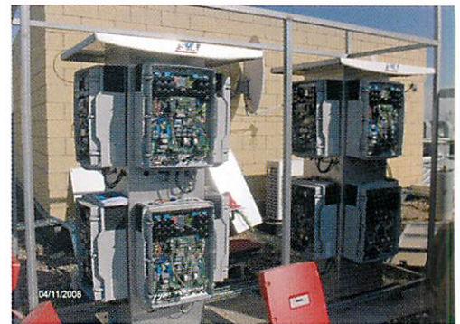
A la izquierda, detalle del cableado, que no interfiere en el drenaje de la cubierta. A la derecha y abajo, inversores de conexión a red, responsables de conversión de la energía de continua a alterna.
