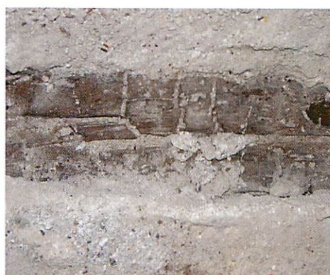
Vigueta con ataque por hongos de pudrición.
