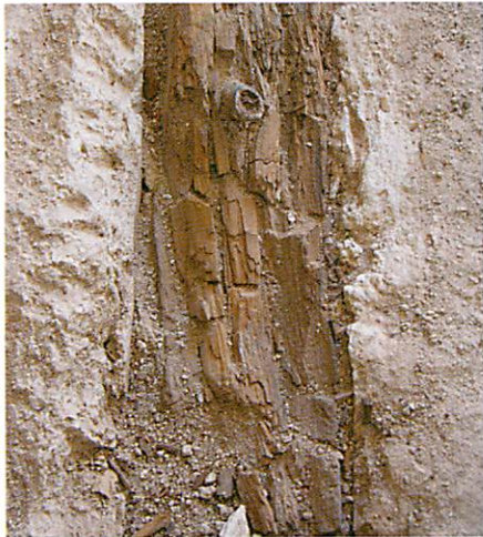
Ataque por hongos de pudrición parda.
