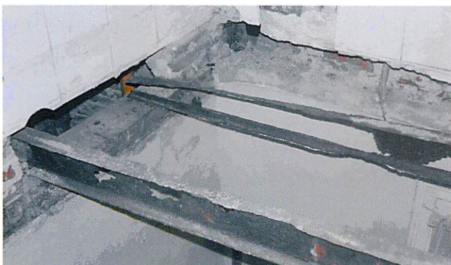
Forjado de viguetas IPN de acero laminado, con 10 años de antigüedad, en una vivienda del casco urbano de Madrid.
