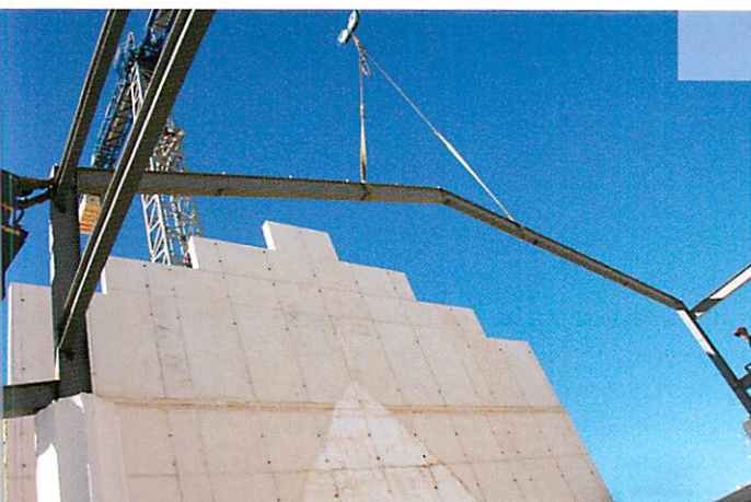
En la construcción de la estructura portante de la cubierta se empleó perfilería IPE-270. Con su masividad, la necesidad de resistencia al fuego se solucionaba con pintura intumescente.
