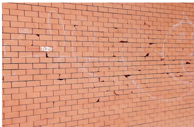
Figura 2: fábrica con junta oculta y existencia de desportillados.
