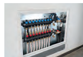
INSTALACIÓN A BAJA TEMPERATURA
