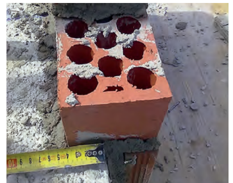
Figura 1: apoyo insuficiente de un ladrillo en borde de forjado.
