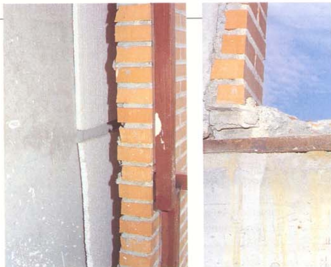
Aplicación deficiente del mastic de la junta de dilatación, encuentros desajustados de materiales y unión mal ejecutada entre peana y jamba de ladrillo.
