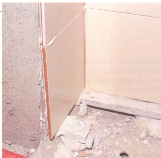
Azulejo desprendido en alicatado.
