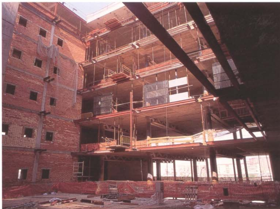
En cuanto a seguridad, en el sector de la construcción predomina la improvisación.
