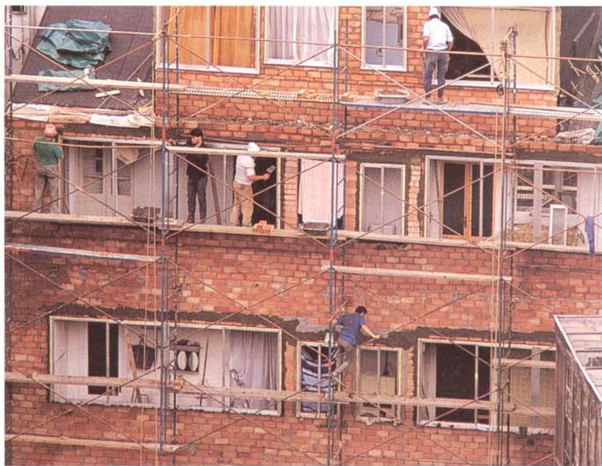
Andamio en condiciones de cumplimiento nulo de las condiciones de seguridad.
