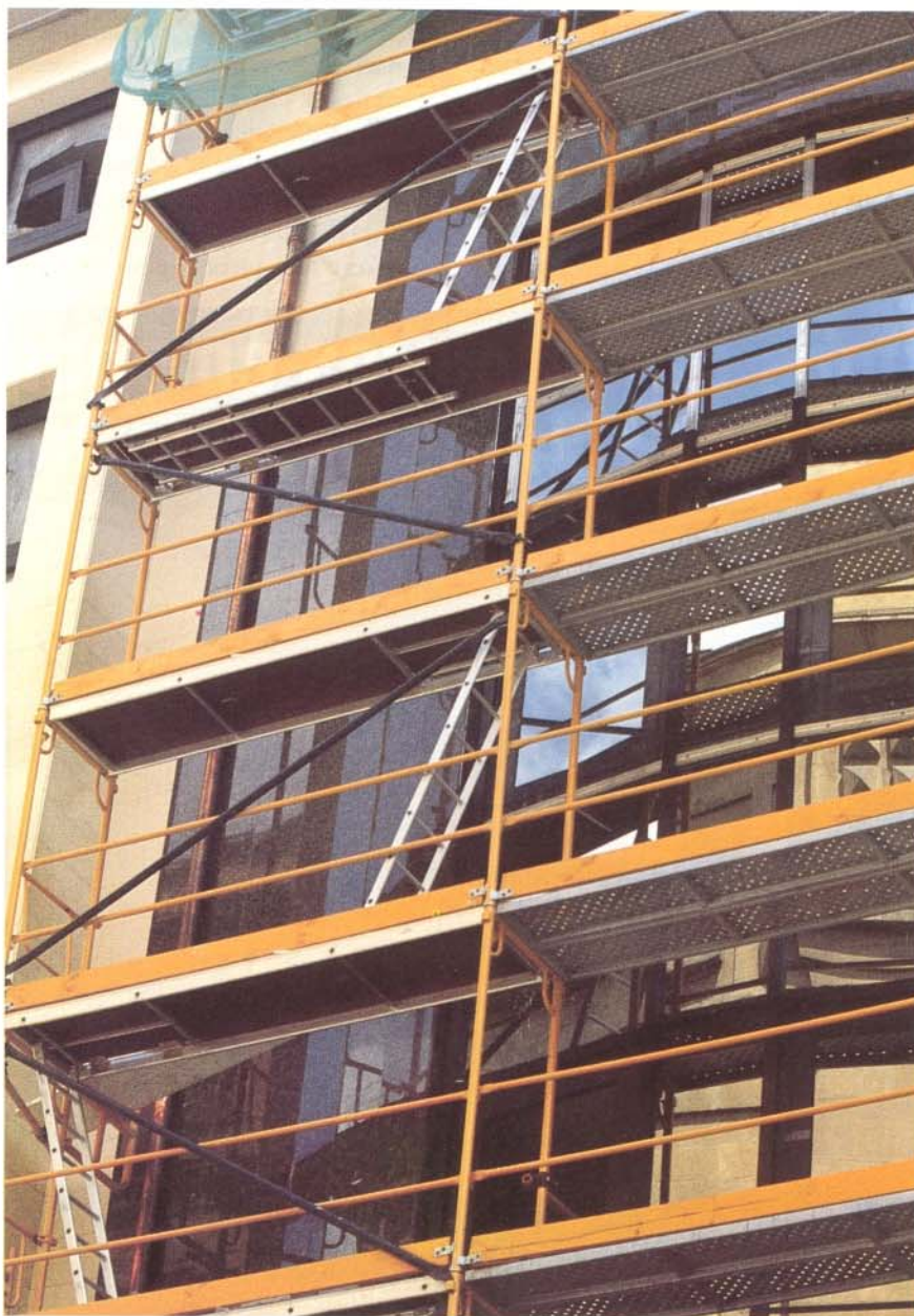
Vista parcial de un andamio HD-1000.
