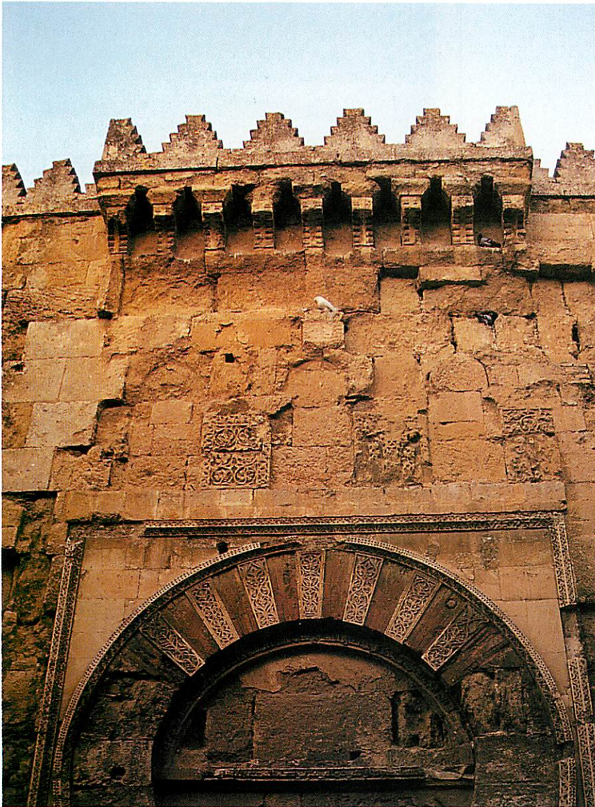
Lesiones por humedad en fábricas de tapial.
