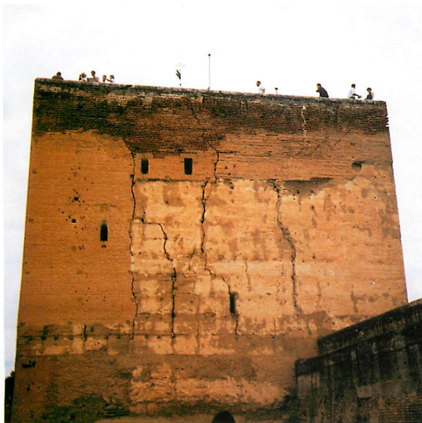
Fisuración vertical de las fábricas.
