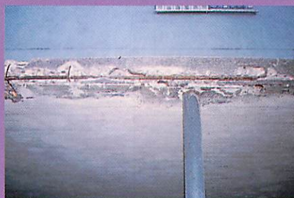
Figura 13: Anclaje comprometido de una barra corroída.
