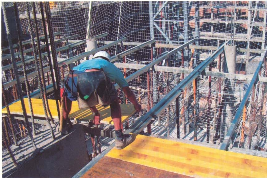
Riesgo de caída de altura en el montaje de encofrados continuos, evitado con la colocación de una red de seguridad bajo forjado.
