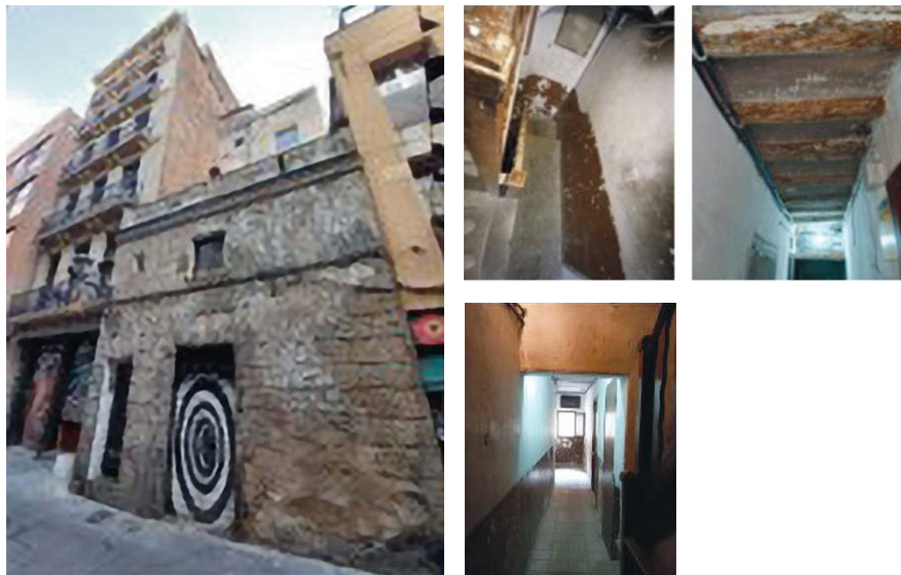
Ilustración 2. Vista exterior e interiores del edificio antes de rehabilitar de C/ Cendra 9. Raval. Barcelona.
